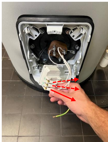
5.5 Déconnecter du thermostat les 3 cosses de la stéatite ( ne pas dévisser les câbles d'alimentation sur le thermostat )
